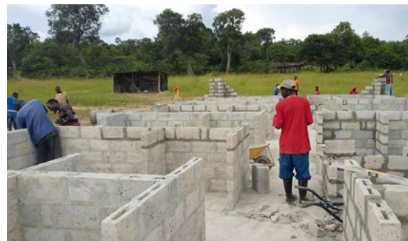
Die einzelnen Schlafräume sind vom Grundriss bereits zu erkennen. Foto: Brücke der Freundschaft e.V.
